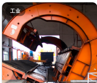
工业 中电建翻车机运维试点
